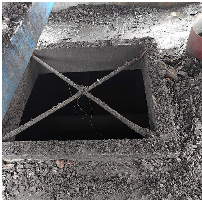
图 4 人员掉落清理口图（中间十字钢筋是事发后焊接的）
